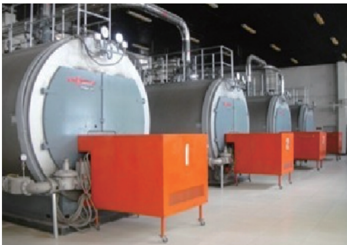
图4 锅炉节能改造
