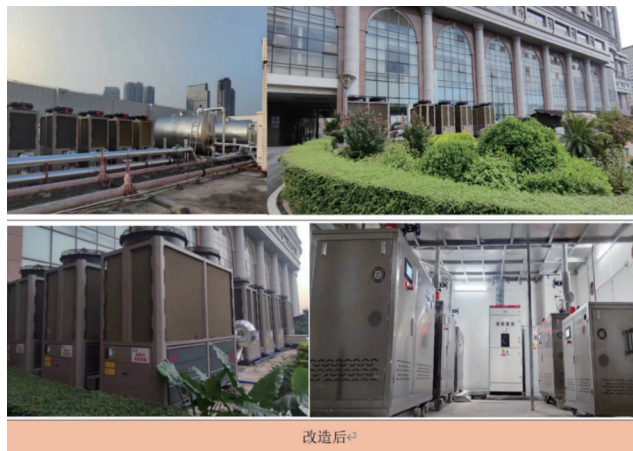
图 9 因地制宜采用小型化的热泵、蒸汽发生器、电热水锅炉等方式
