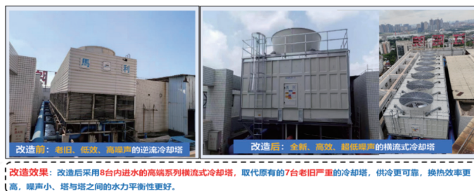
图 12 冷却塔更新改造前后对比
