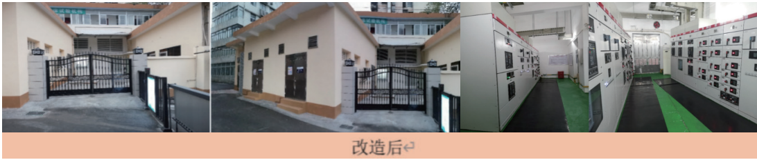
图 7 安全、配电冗余充足的智能配电房（改造后）
