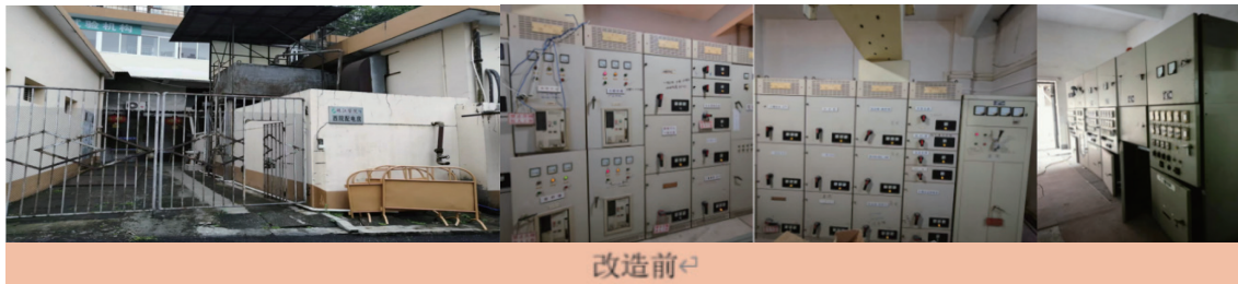
图 6 投用 20 年以上，存在严重安全隐患且配电容量不足的老旧配电房
