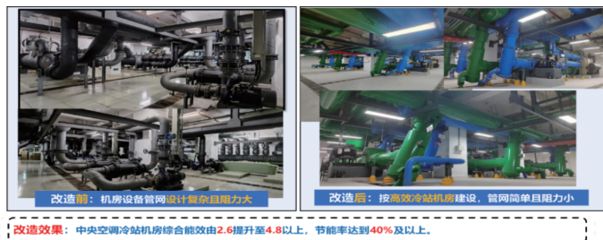
图 11 冷站机房整体改造前后对比
