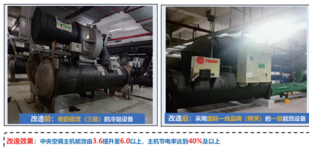
图 10 冷站机房冷水主机改造前后对比
